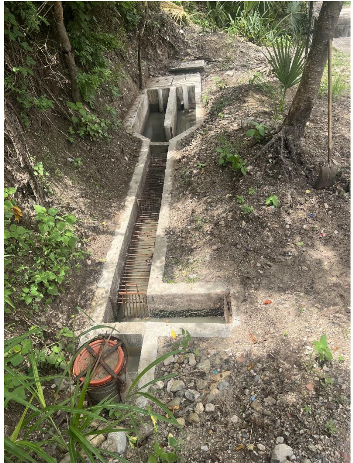
Canal de rejas, rejillas y desarenadores
