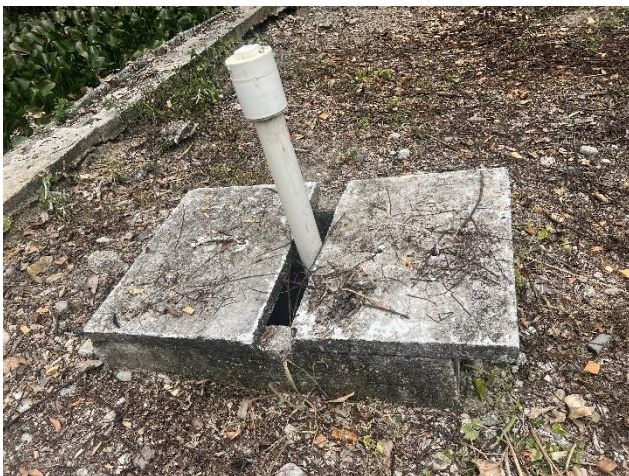
Tanques de cloración
