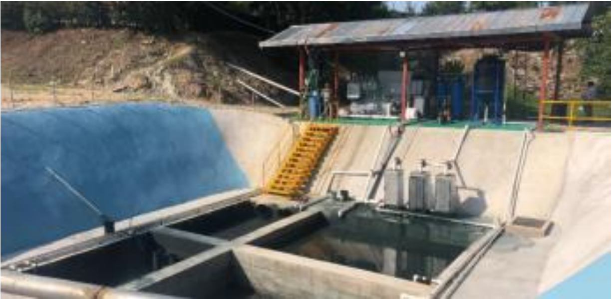
Figura A1 Sistema de Tratamiento de Agua Residual Especial
