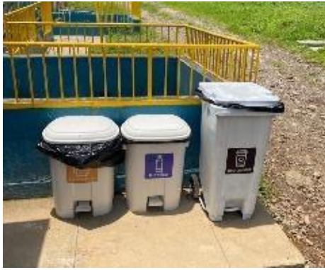
Anexo 13. Instalación de recipientes en área de Planta de tratamiento de aguas residuales industriales.
