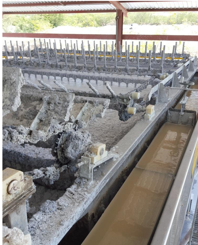
Figura 6. Planta de tratamiento de agua residual
